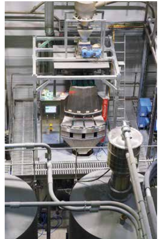
Auf Kundenwunsch integrierte Unisensor die Laser-Sortiereinheit in die moderne Aufbereitungsanlage für PET-Flakes.
